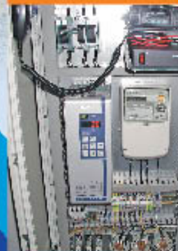
The switchboard Станция управления
